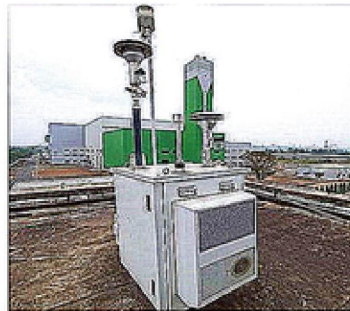
厂区中心微站
